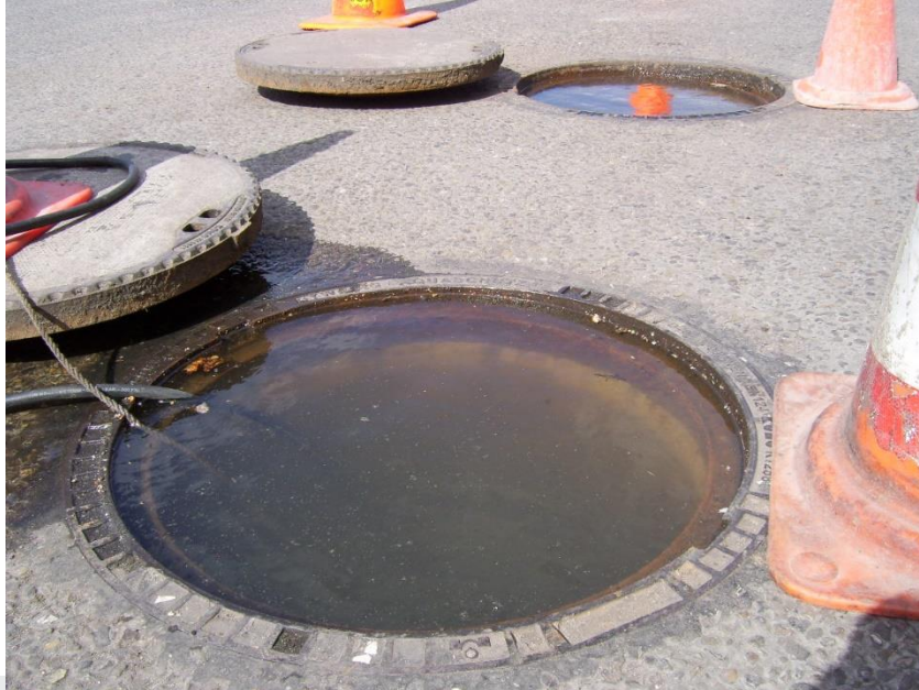
Foto: Hydrologische meting afscheidingsinstallatie
