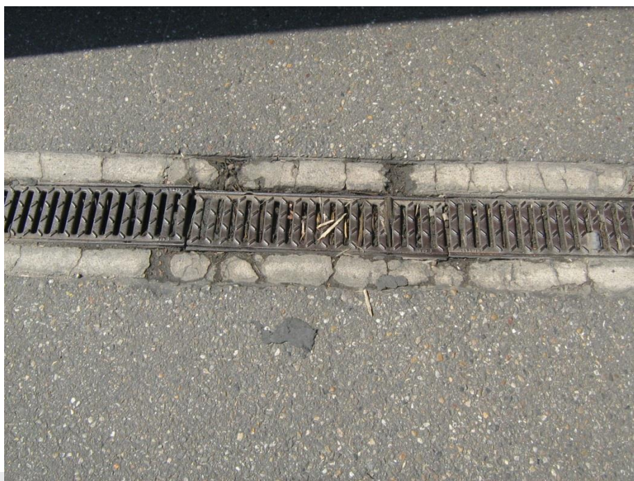
Foto: Aansluiting op lijngoot.
