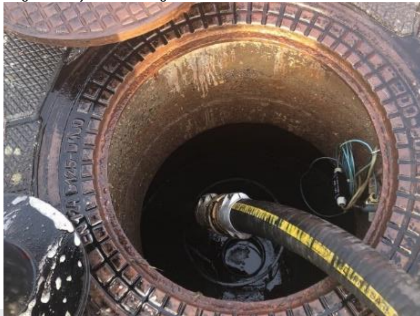
Foto: Leegzuigen afscheidingsinstallatie
