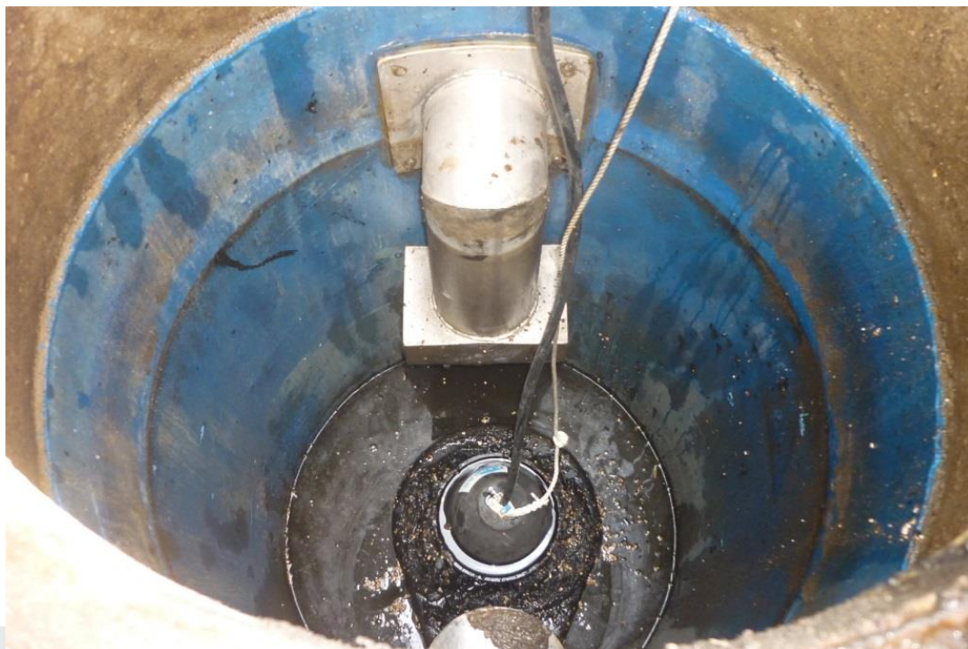
Foto: Afsluiter in afscheiderinstallatie.
