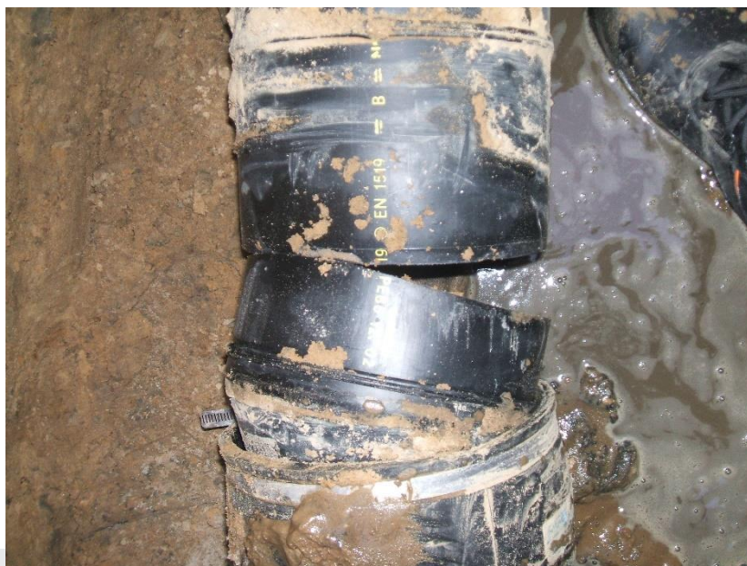
Foto: Lekkage/breuk in leidingwerk.
